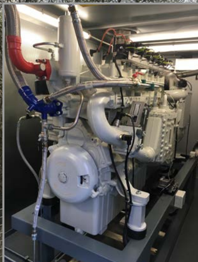
Das neue Blockheizkraftwerk zur Deponiegas- nutzung im Entsorgungszentrum „Alte Schanze“
