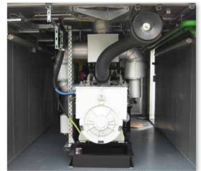
Neuer BHKW-Gasmotor - seit 2011 in Betrieb
