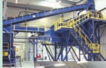
Sortier- und Aufbereitungs- anlage
